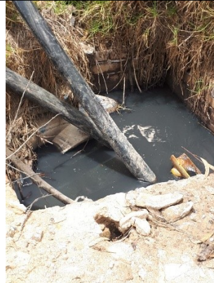
Fotografía 16. Estructura subterránea con agua impactada
